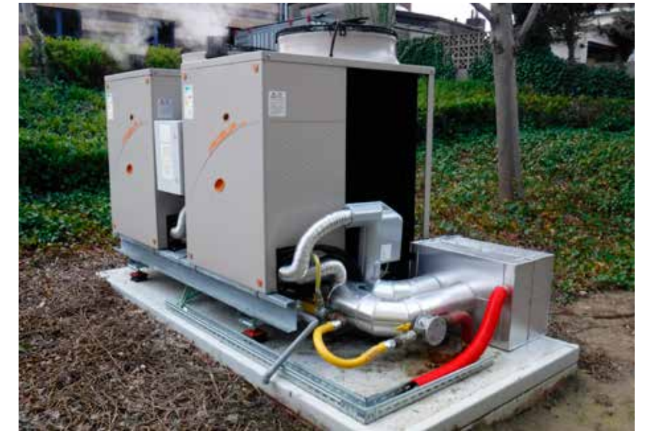
De vernieuwde stookplaats verbetert de efficiëntie van het gemeentehuis van Steenokkerzeel.
